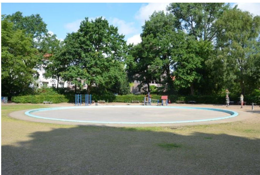
Das Planschbecken am Biedermannplatz ist sanierungsbedürftig. Foto: C. Reiffert
